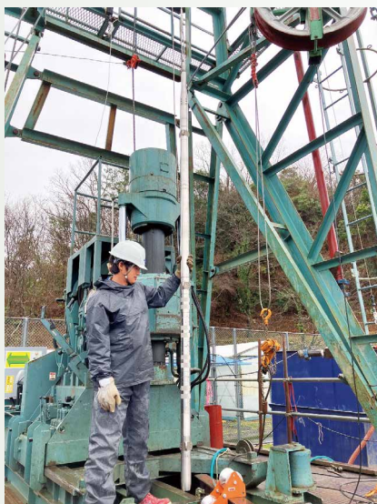
写真1 宮崎県延岡市に設置した新規開発のひずみ計（ボアホールひずみ観測装置）の外観埋設作業でひずみ計を観測井戸の中に降ろしていく直前の様子。
